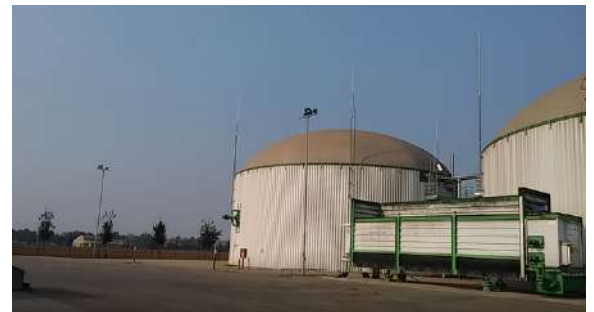
Figura 2: Uno degli impianti di biogas per la valorizzazione e buona gestione degli effluenti di allevamento (foto: staff LIFE DOP)
